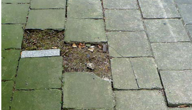
Defekte Gehwege können Gefahrenquellen bilden und werden von der HaNeuer-Verwaltung ausgebessert.
